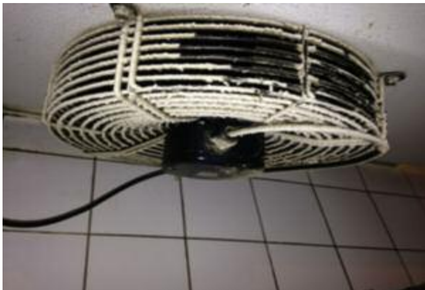
Abb. 22 Staubablagerungen auf dem Schutzgitter eines Kühlraum-Ventilators behindern einerseits die Luftzirkulation und sind auch eine Kontaminationsgefahr für die aufbewahrten Lebensmittel.
