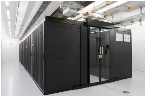
Bild 16: Einhausung in einem Rechenzentrum
